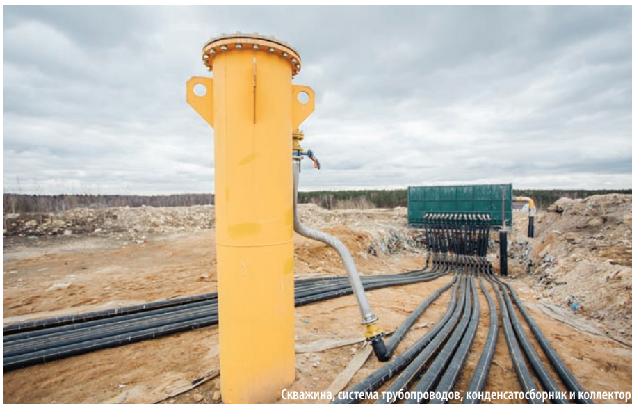
Скважина, система трубопроводов, конденсатосборник и коллектор
